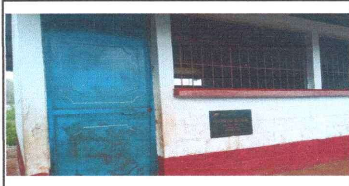
Foto 4: Se observa el deterioro de la pared y desprendimiento de la pintura de las paredes del edificio educativo. Largo 11.86 mts de longitud por un ancho de 6.01 metros
